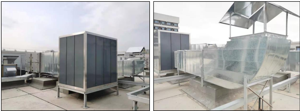
图 4-4 餐饮废气排气筒
