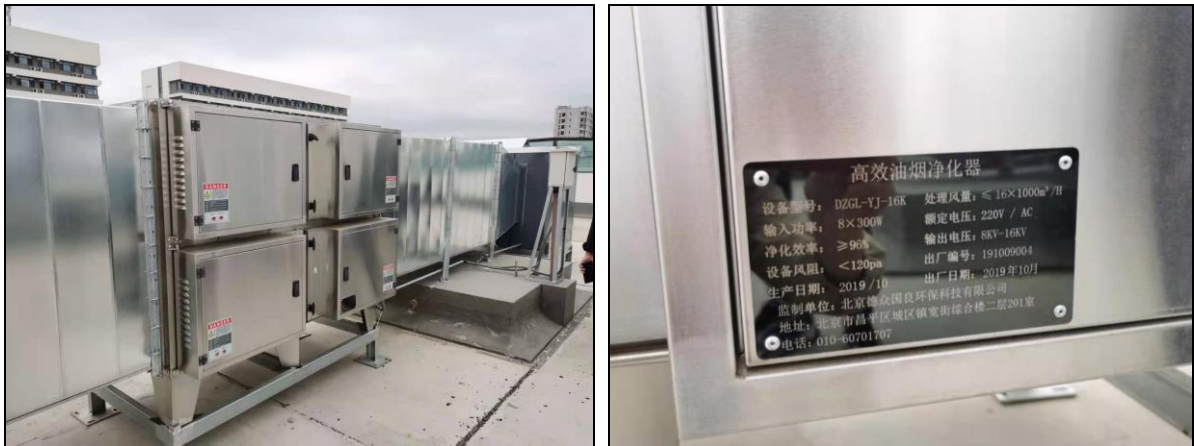
图 4-3 餐饮废气净化设施
